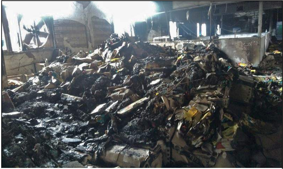
发生火灾的车间
