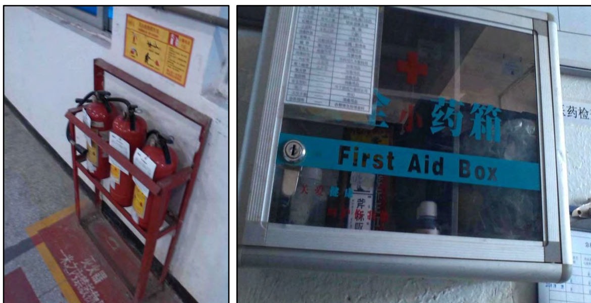
车间消防器具和急救箱
