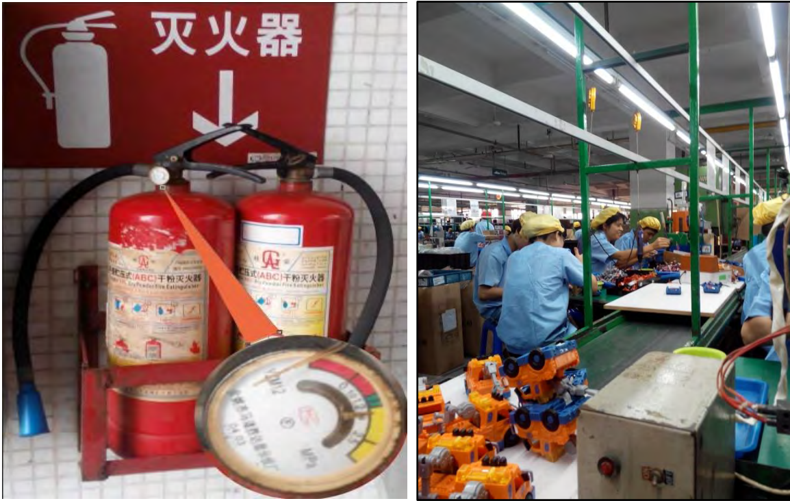
左：灭火器压力超出正常值；右：生产线上的工人
