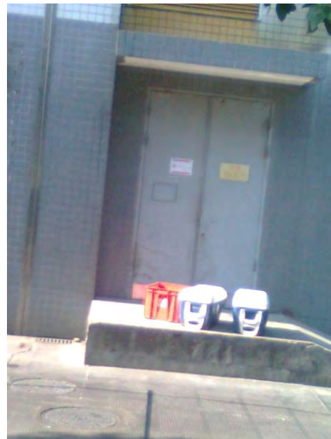
仁宝紧急出口大门紧闭，有杂物堆放
